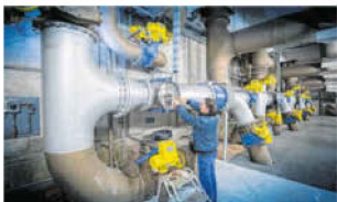
Revision im Wasserwerk. Foto: Volkmar Könneke
